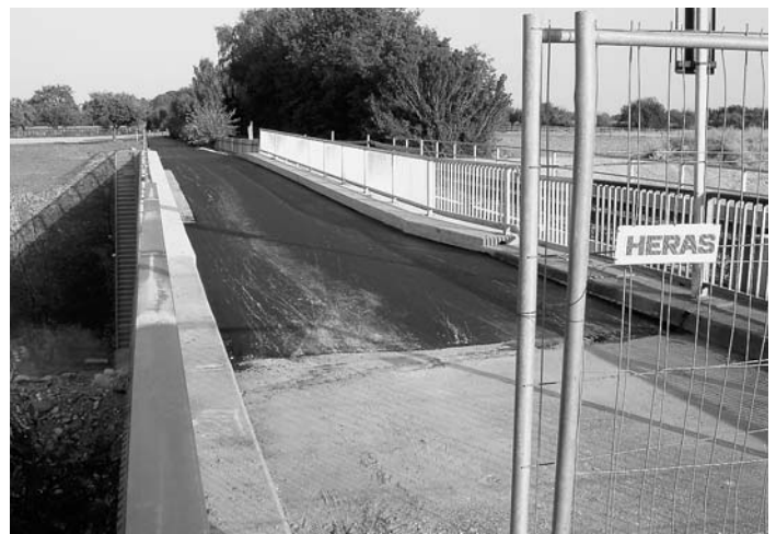
Die erneuerte Brücke war zum Zeitpunkt des Fotos Anfang September noch nicht freigegeben. Die Wegoberfläche wurde leider nur im Bereich der Brücke verbessert, der Feldweg ist nach wie vor recht holperig.
